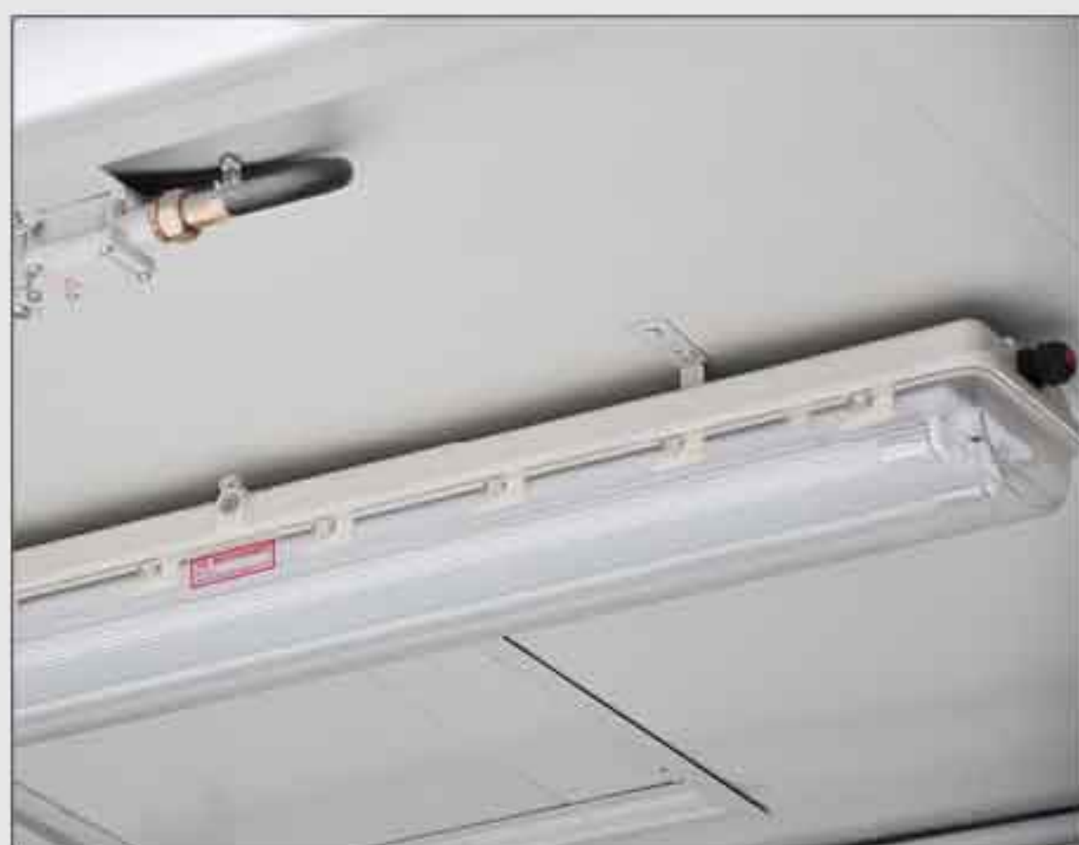
防爆照明系统
