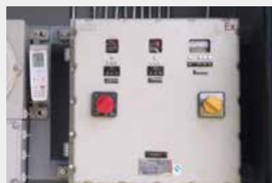
防爆配电及控制系统
